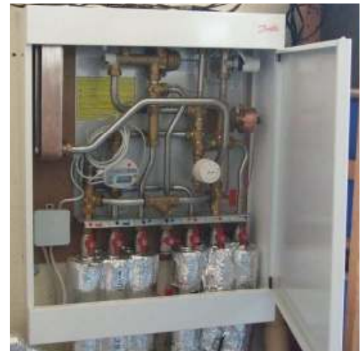
dezentrale Übergabestation für Heizung und Warmwasserbereitung in einem kleinen Wärmetauscher (links oben) in einem Mehrfamilienhaus in Trier
